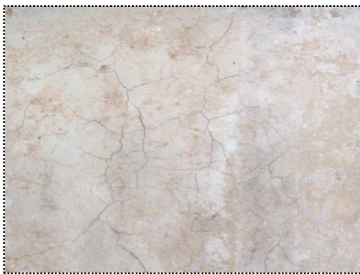
الصورة توضح تولد الشقوق
